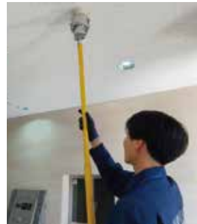
消防法定点検
