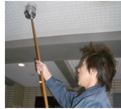
消防法定点検
